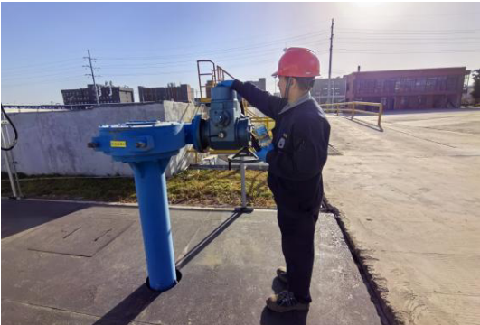
现场人员模拟关闭厂区雨水外排阀门
