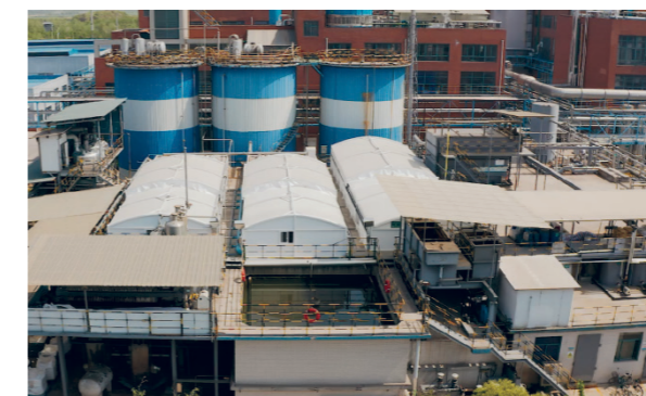
污水处理设施厌氧塔
